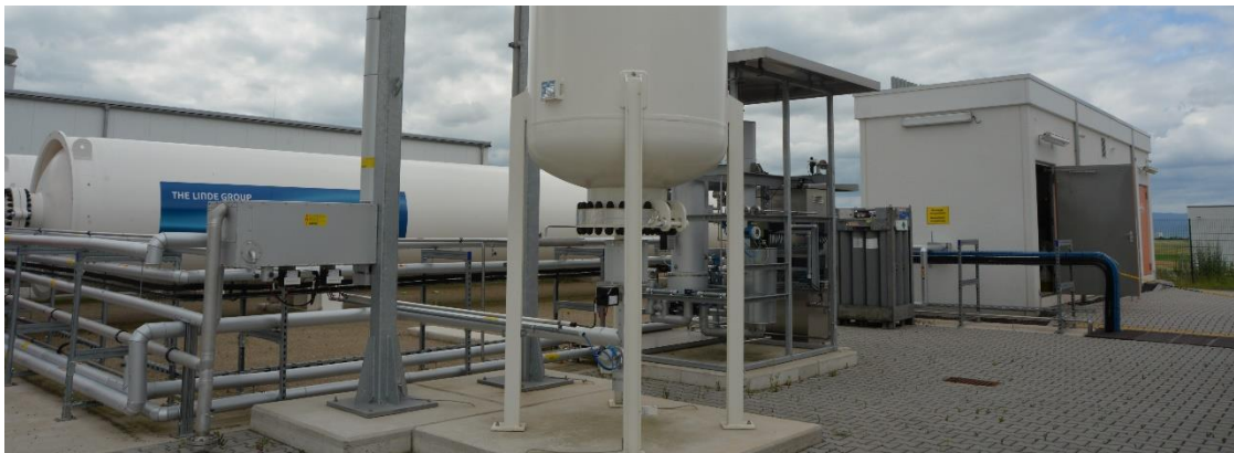
Gasspeicher und Gasnetzeinspeisung
