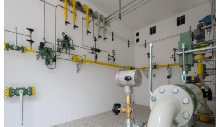
Quelle: Energiepark Mainz
